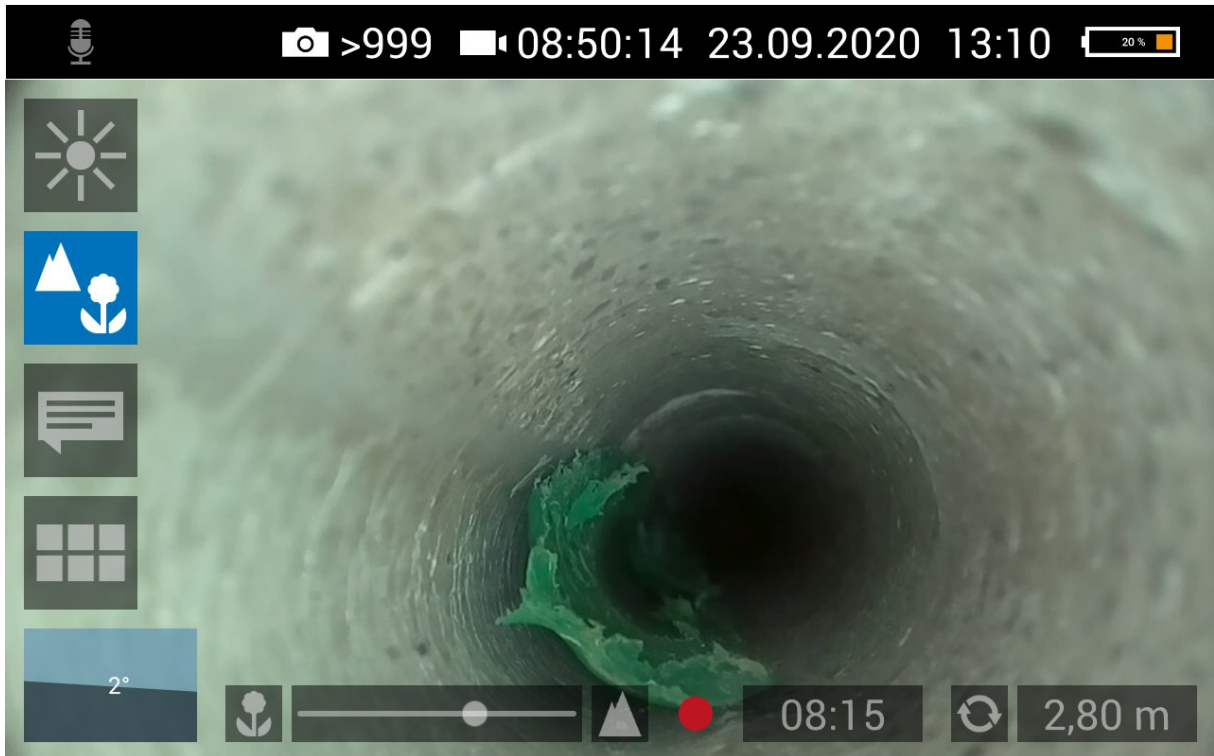
Abbildung 28: Kunststoffreste in Bohrung
