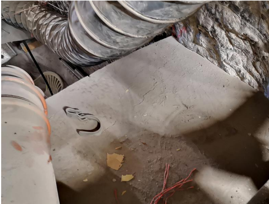
Abb. 8: Damm Zustand linke Ecke 28.06.2022
