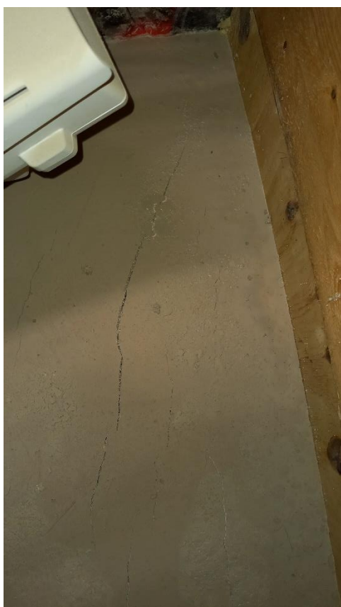
Abbildung 76: Oberflächenrisse an der Schalung
