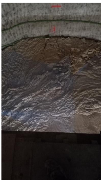
Abbildung 70: Schaumansammlung an dem tiefsten Punkt des Betonagelevels
