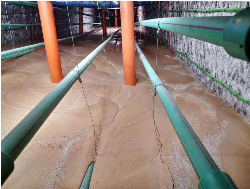
Abbildung 69: Rissbildung an der Oberfläche zu Beginn der Spätschicht am 27.07.2021 16:36 Uhr
