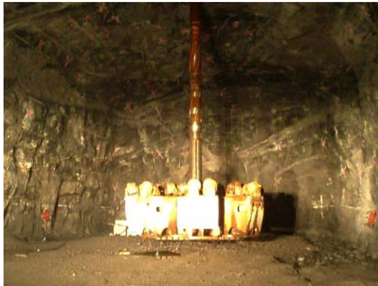
Abbildung 6-1: Raise-Bohrkrone für die Erstellung des Personenschachtes für die Rock Characterization Facility ONKALO, Finnland [Posiva]
