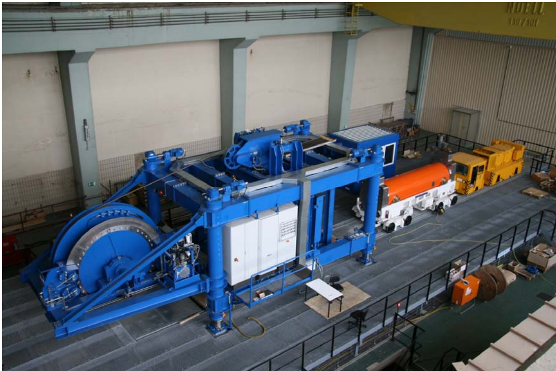
Abbildung 5-50: Versuchsstand Landesbergen mit der Einlagerungseinrichtung für die Bohrlochlagerung (blau, links) sowie die Grubenlok mit dem Transferbehälter auf einem Plateauwagen – Deutschland
