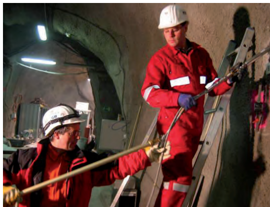
Abb. 68: Durchführung von Bohrlochverformungsmessungen zur Bestimmung des Gebirgsverformungsverhaltens (URL Mont Terri; Quelle: BGR)
