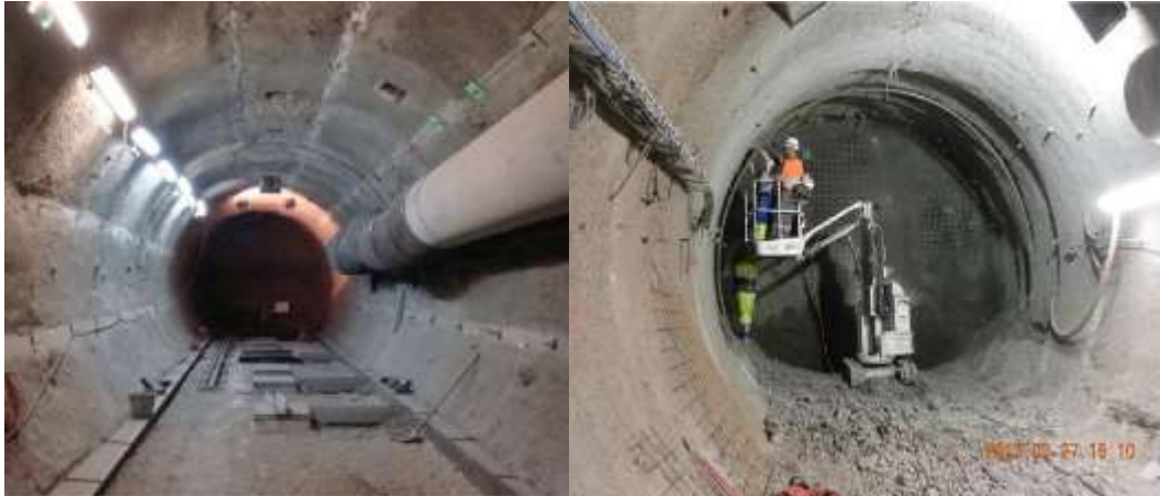
Abbildung 2-41: Untertagelabor Meuse/Haute-Marne Ausbau der Strecken GCS (links) und GCR (rechts) (Armand et al., 2013)
