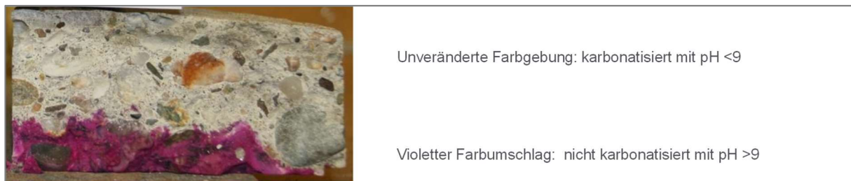
Abbildung 5-14: Phenolphthaleintest an einem teilweise karbonatisierten Beton
