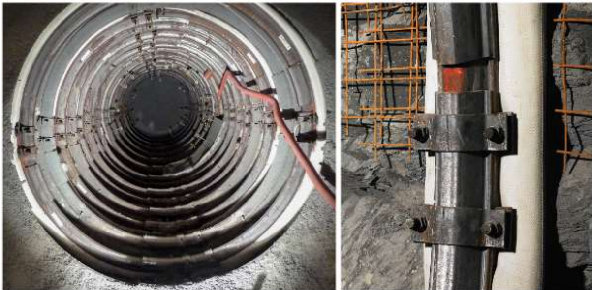
Abbildung 2-35: Links: Blick in den Abschnitt der späteren Zwischenversiegelung mit Gleichbogenausbau im FE-Experiment, rechts: Detailansicht eines Gleitbogens ergänzt durch Bullflexschlauch und Mattenverzug zur Kontursicherung (Nagra, 2015)
